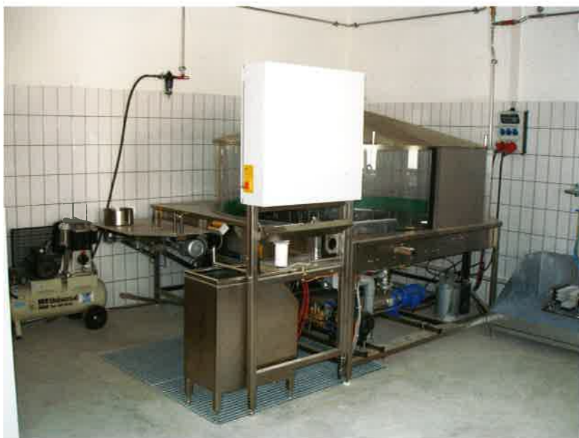
Die neue Schlauchpflegeanlage, mit der auf 12 qm Nutzfläche die Schläuche gewaschen, druckgeprüft, getrocknet und gewickelt werden können.
